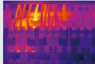
Entretien les installations : détecter des températures trop élevées au niveau des fusibles et des composants électriques avant que des pannes ne se produisent.
